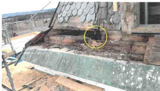
Eksempel på råteskade i tårntakets bunnramme og opplegg på tårnveggene. Markeringen viser skadepunkt med omfattende vednedbrytning i sammenføyningen mellom tårnsperre, bunnsvill og en strekkbjelke.
