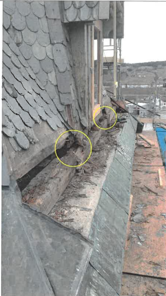
Råteskade i tårntakets svill og opplegg på murveggene, og i sammenføyningene mellom tårnsperrene.
