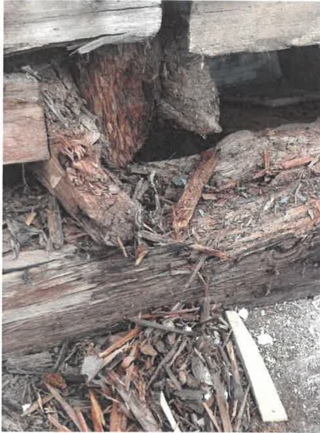
Eksempel på råteskadet sammenføyning mellom bunnsvill, sperrefot og en strekkbjelke. Sammenføyningen har gått helt i oppløsning.
